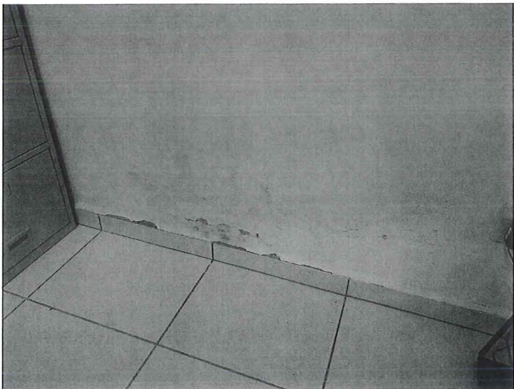
Imagem 08: Mofo na parede do almoxarifado
