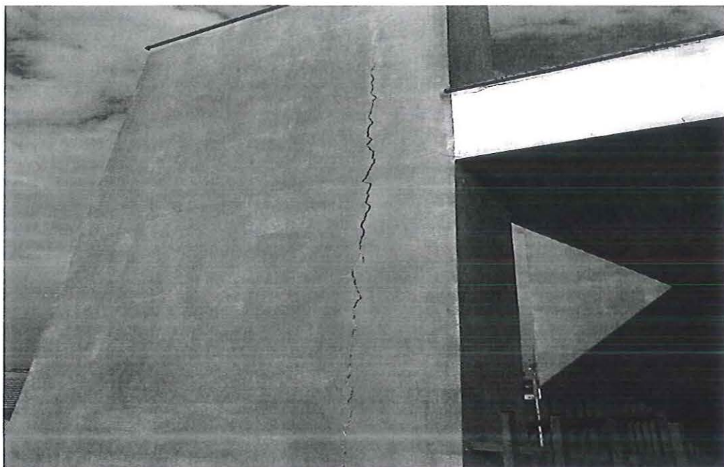
Imagem 03: Fissuras no pilar da rampa de acesso das ambulâncias
