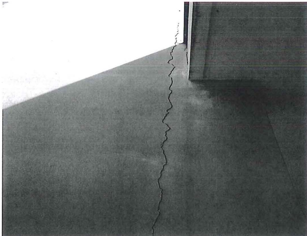
Imagem 04: Fissuras no pilar da rampa de acesso das ambulâncias
