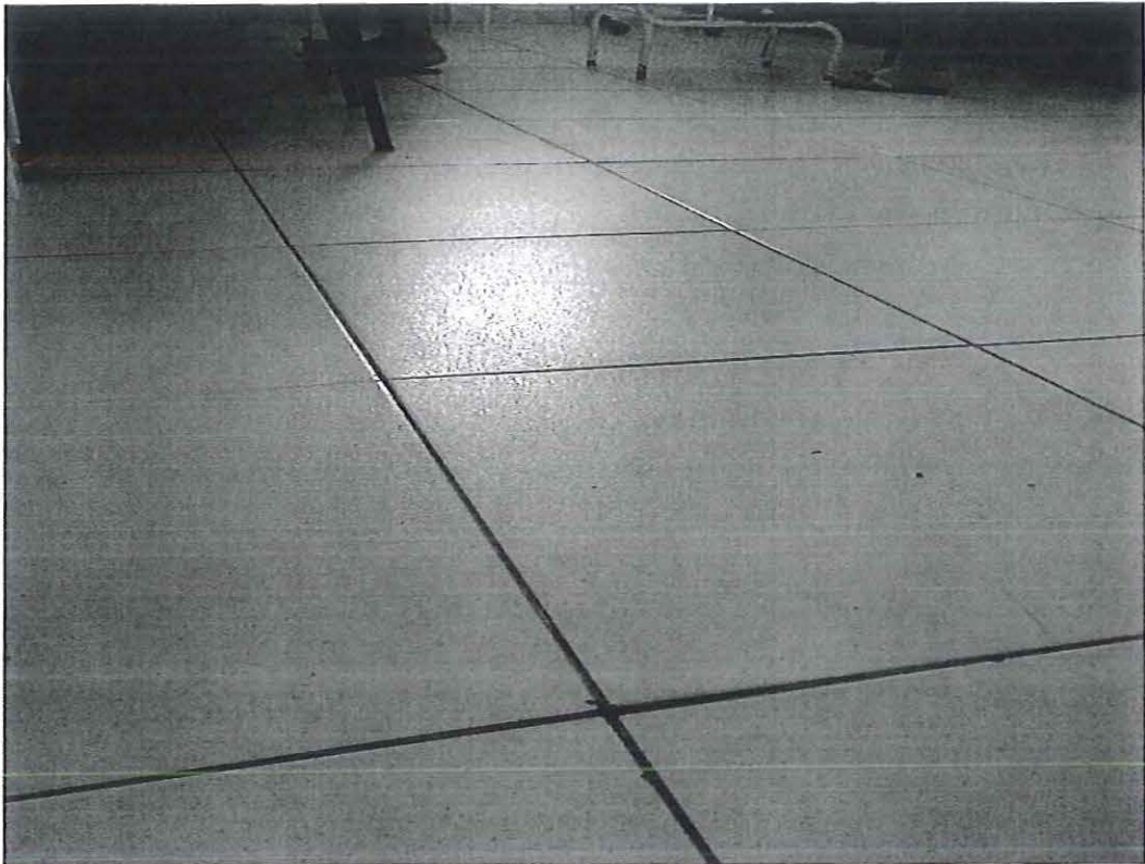
Imagem 07: Piso cerâmico solto na sala de isolamento masculino
