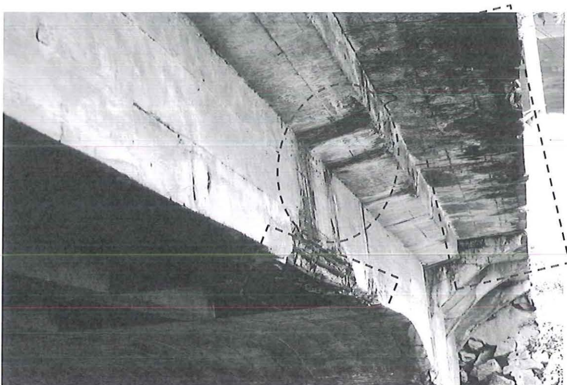
Figura 5 – Lixiviação com perda de cobrimento do concreto, com armadura exposta em avançado estado de corrosão na longarina, localizada próximo ao centro do vão da estrutura, onde se dão as maiores tensões no bordo inferior das vigas
