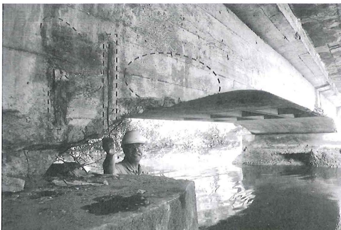
Figura 2 – Perda de seção do concreto, armadura exposta em avançado estado de corrosão e pontos de lixiviação distribuídos na estrutura da ponte, junto ao apoio do lado esquerdo da Figura 1
