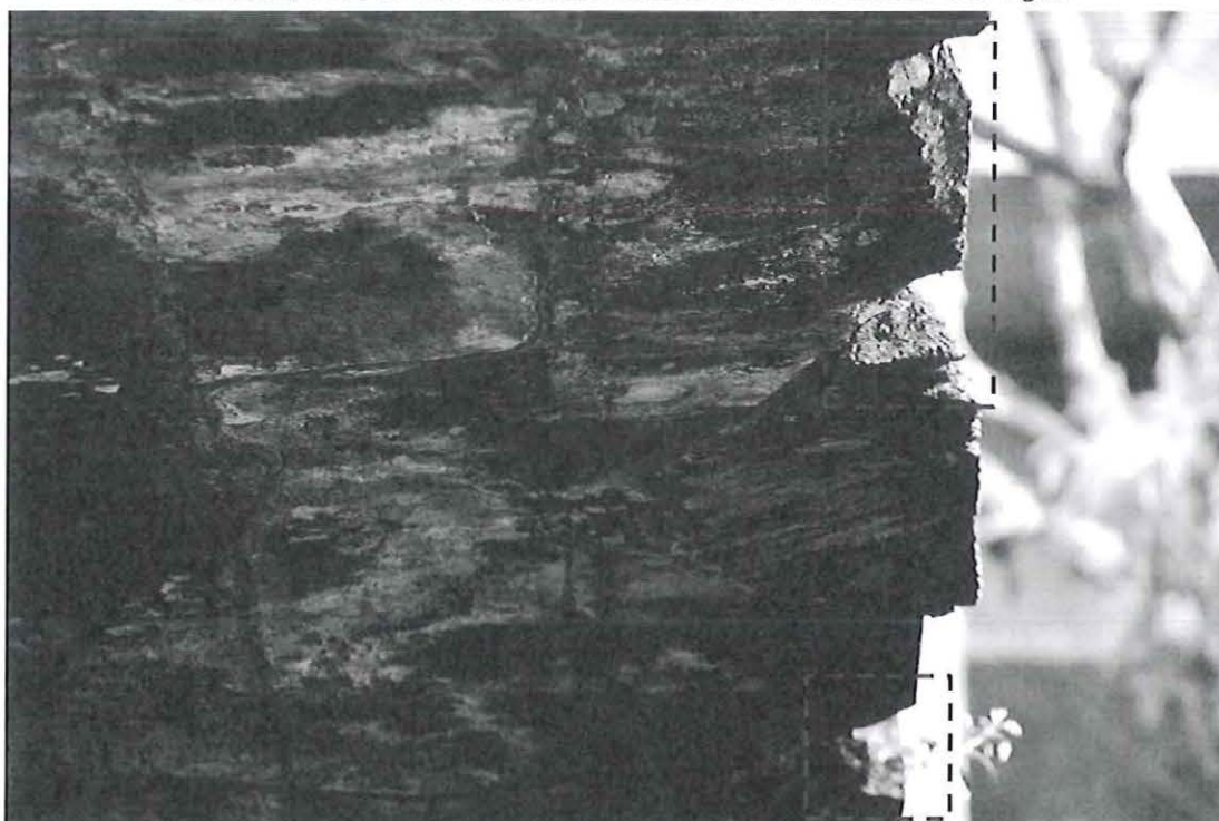
Figura 6 – Lixiviação e infiltração em demasia, com pontos de atenção para esborcinção do concreto na estrutura da ponte
