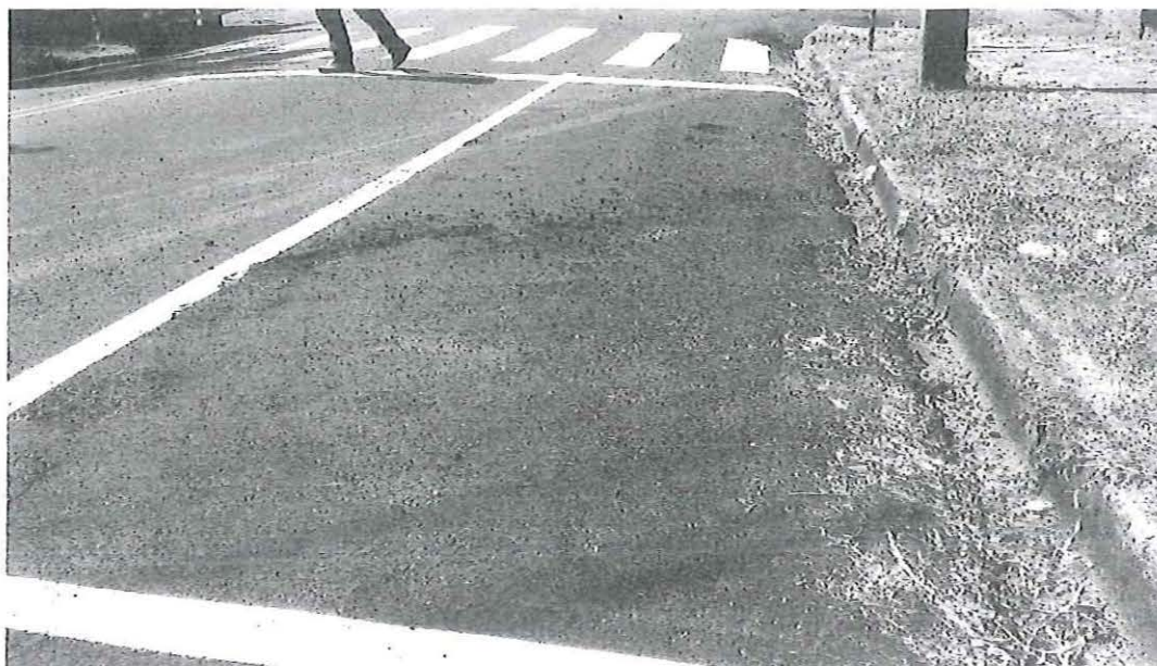
Foto 8: Afundamento (Rua Visconde de Nacar)
