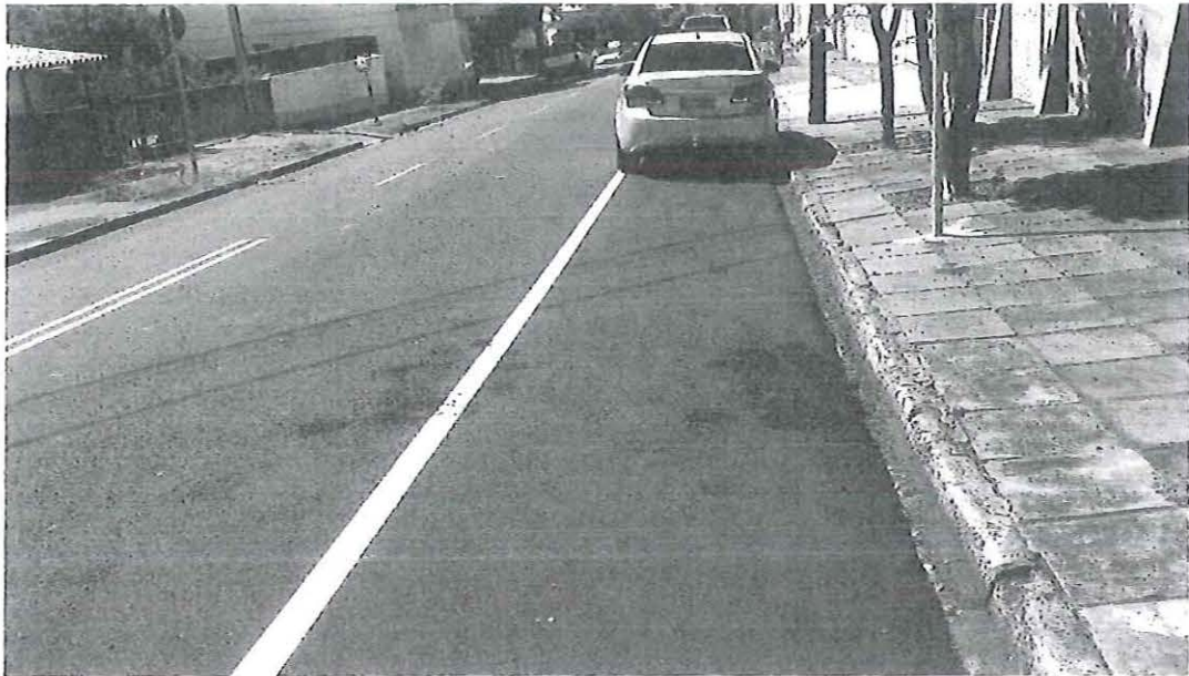
Foto 8: Desgaste superficial (Rua Venceslau Braz)
