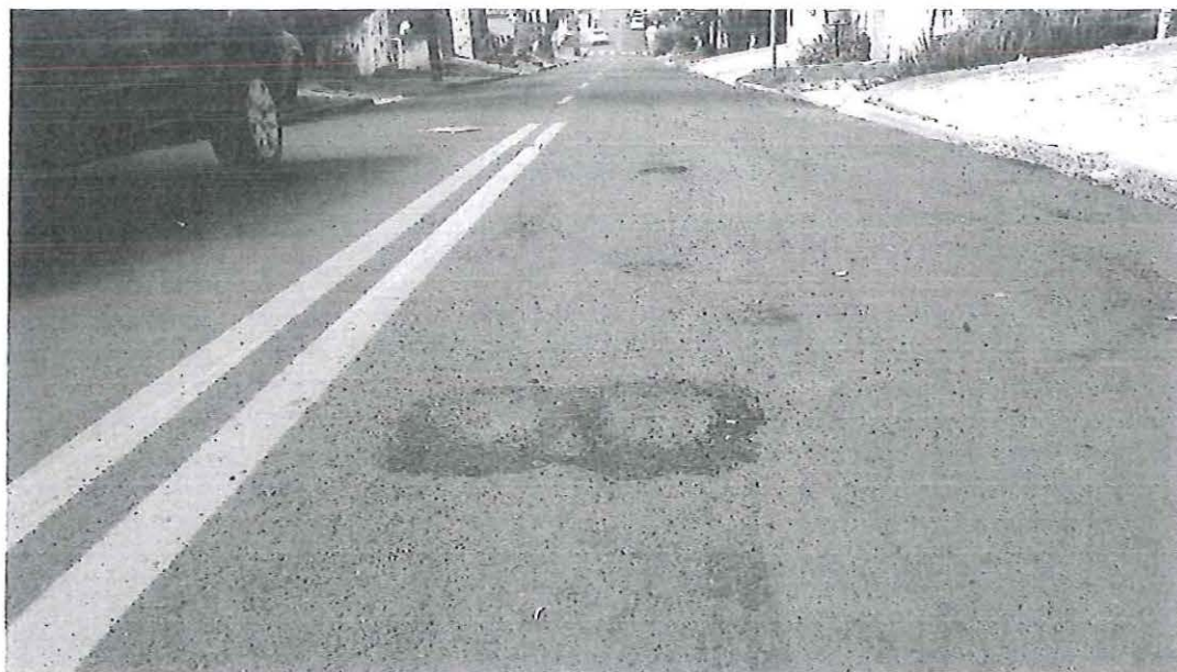
Foto 8: Afundamento (Rua dos Canários)
