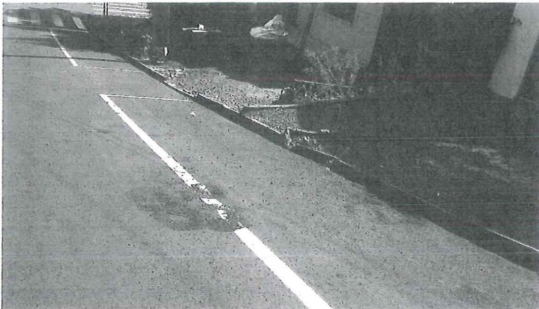
Foto 8: Afundamento (Rua Pedro Ivo)
