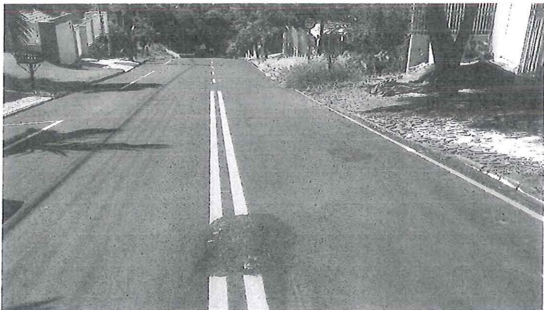
Foto 8: Afundamento (Rua Clarice Cerqueira)
